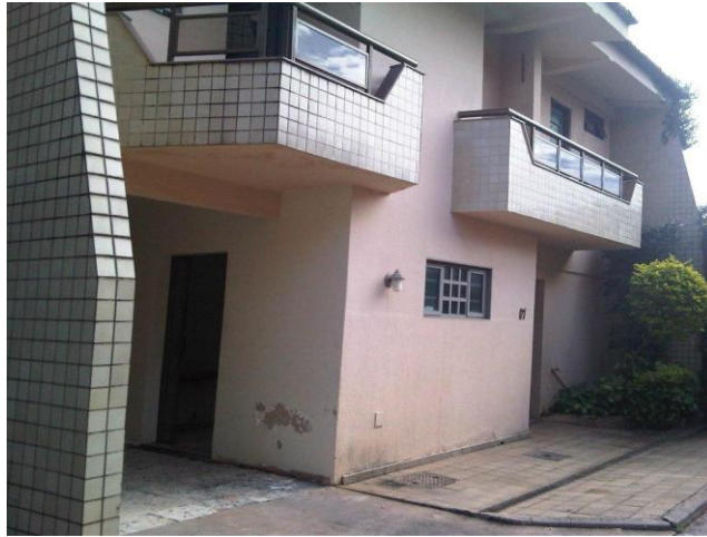
Foto da fachada e primeiro contato com a manifestação patológica
